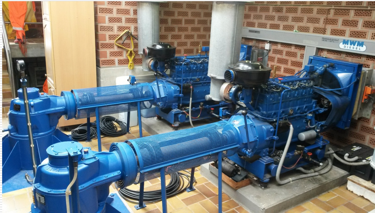
Regenwasserpumpwerk Kinzigheimer Weg (ehem. Kläranlage)
